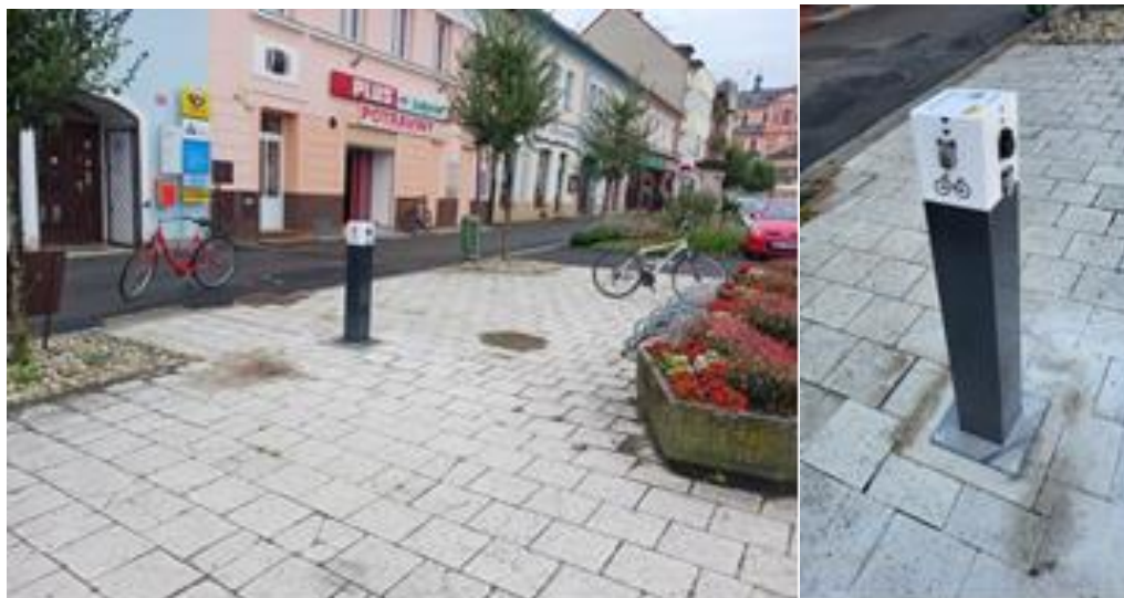
Obrázek 5 - Nabíjecí stanice pro elektrokola
